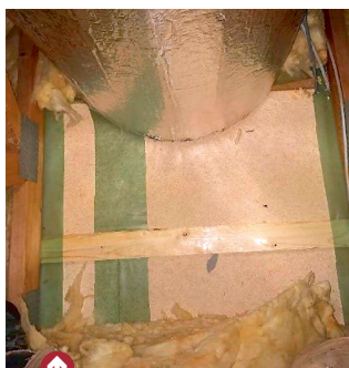
Billede 3. Manglende randafdækning rundt om loftudsugningen, hvilket vil resultere i kolde stier nedenfor skorstenen og varme stier længst væk fra skorstenen.
