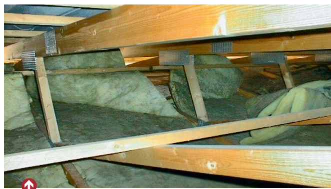
Billede 4 viser, at isoleringen er blæst op
